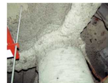
吹付け石綿 （鉄骨材の耐火被覆）
